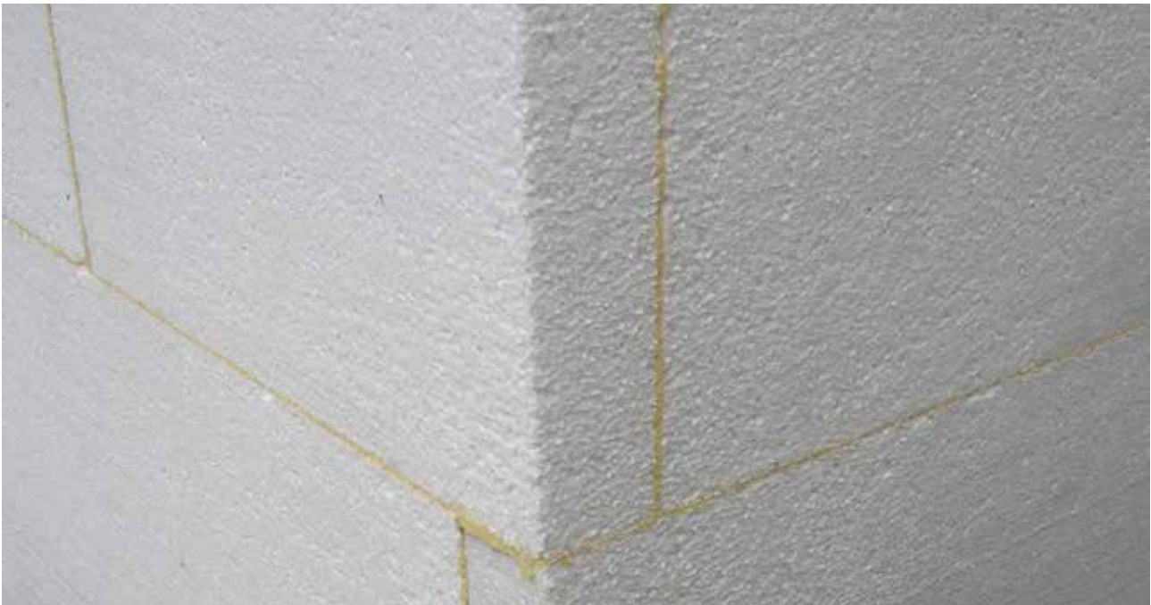
Afb. 14: Open naden opgevuld met PU-schuim.
