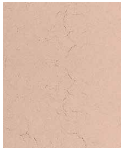
Fig. 25 : Fissures de retrait
