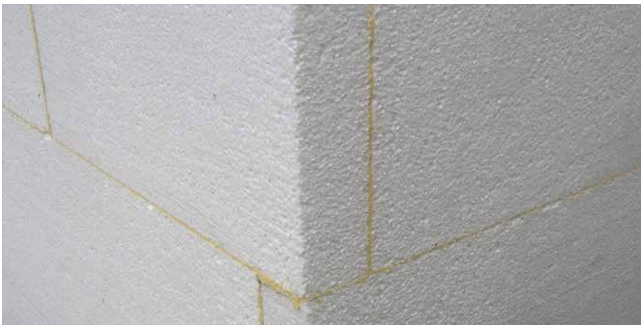
Fig. 14 : Joints ouverts comblés de mousse PU
