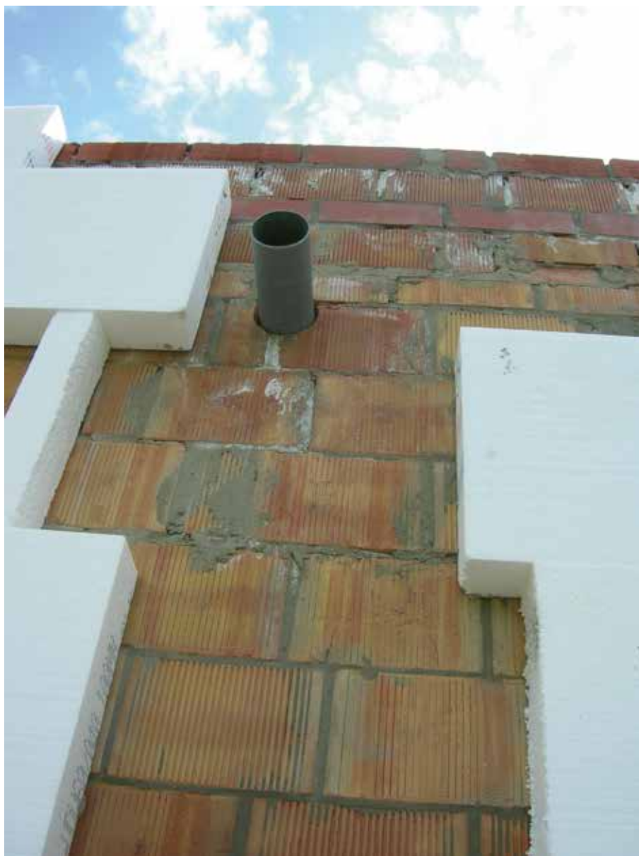
Fig. 9 : Pas de protection contre l'humidité suite à l'absence de rive de toiture et d'évacuation de l'eau de pluie
